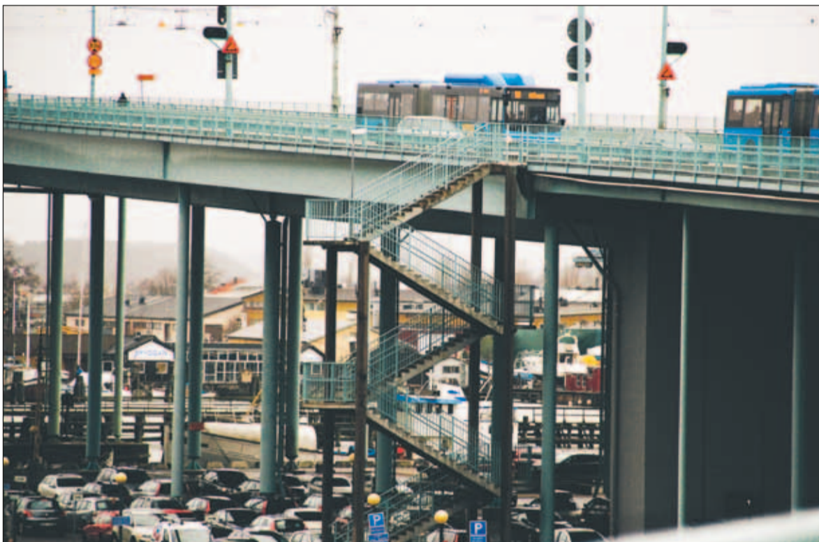
Jobbar än. Den har lite sprickor, men med förstärkningar ska den hålla fram till 2020 när det står en ny bro ett kvarter österut. Göta älvbron är en trotjänare som nu ser slutet på sin bana. FOTO: THOMAS DRAKENFORS
